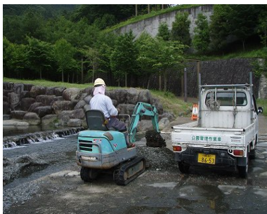
水無川の土石流で冠水した橋上の堆積物を除去し安全を確保し通行止めを回避した
